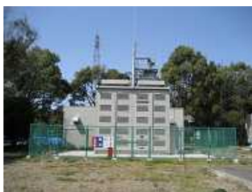
NaS電池設備（甲府市浄化センター）
